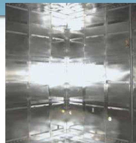
建築工事段階に、室内に磁気シールドを施した構造。架線からの変動磁界を遮蔽することを目的とした磁気シールドルーム。内装は、一般事務所の仕上げ。
